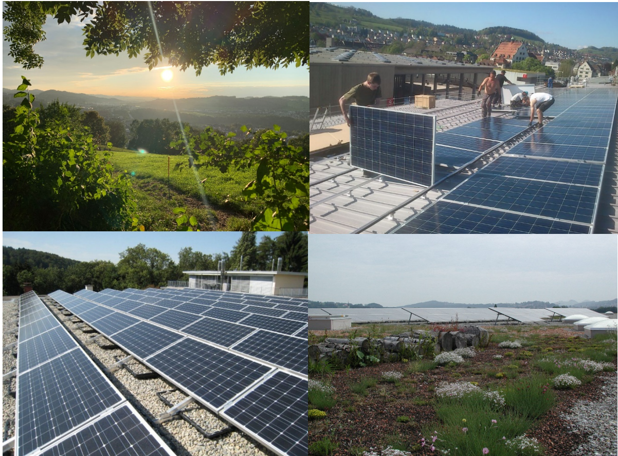
Fotos: Genossenschaft Solar St.Gallen, Stadt St.Gallen
